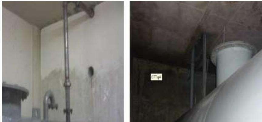
Figura 28. Tanques en bóveda.
