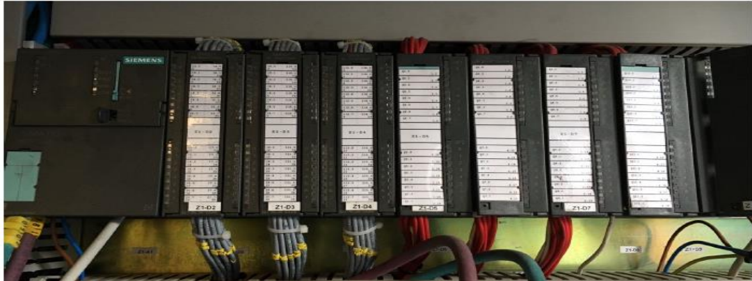
Figura 3. Unidad de PLC Maestra
