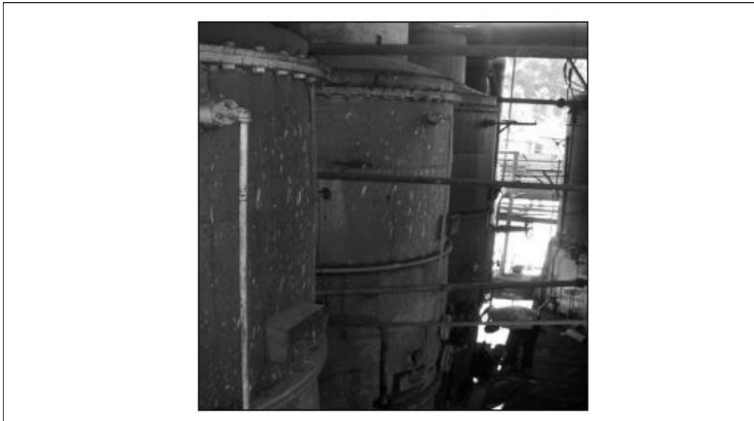
Figura 8. Evaporadores de múltiple efecto
