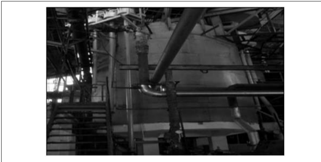
Figura 7. Clarificador de jugo
