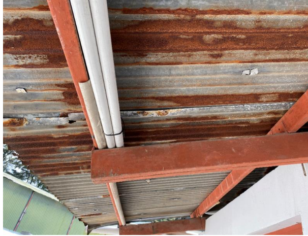
Imagen 7: Daños por falta de mantenimiento.
