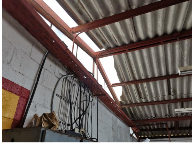
Imagen 8: Daños en edificaciones.
