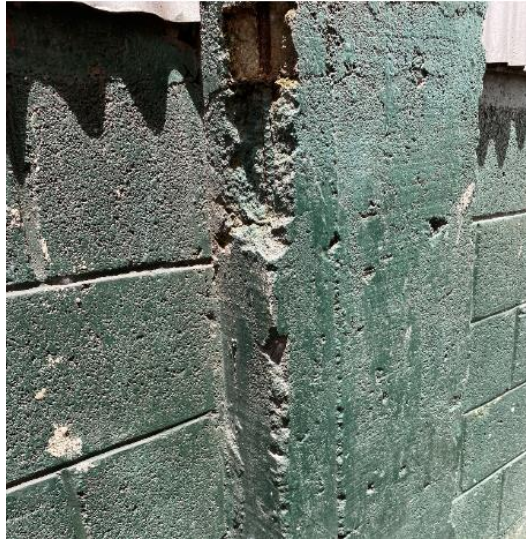
Imagen 11: Columnas con acero expuesto.
