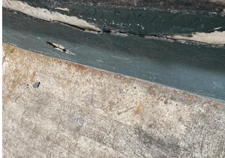
Imagen 6: Daños por mala calidad de materiales.
