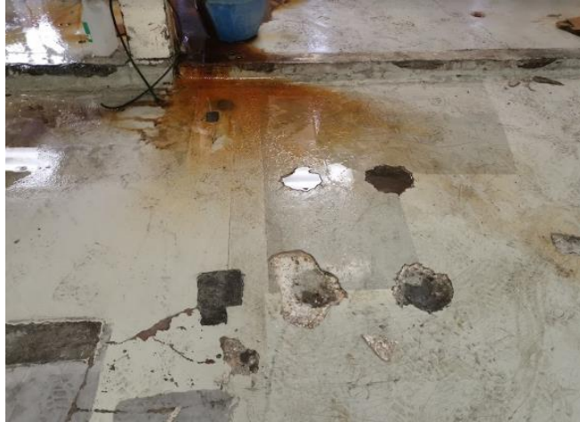
Imagen 15. Estado de pisos epóxicos en áreas de producción.
