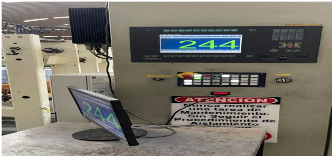
Figura 30: Monitor de Velocidad y fallas
