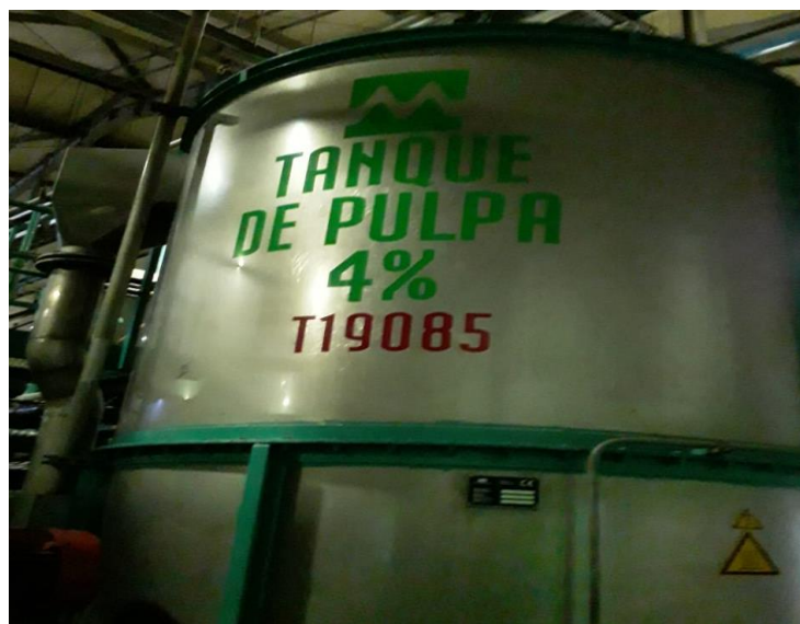
Figura 6 Tanque de pulpa
