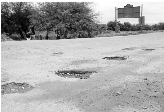
Figura 10: Daños en carretera de pavimento de concreto hidráulico
