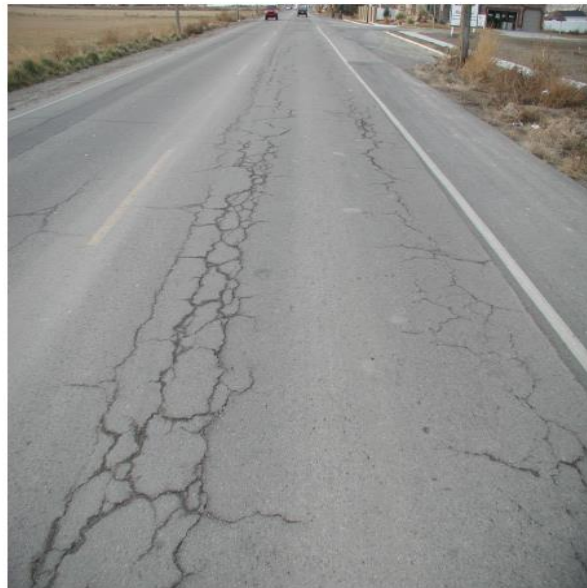
Figura 9: Daños en carretera de pavimento asfáltico.
