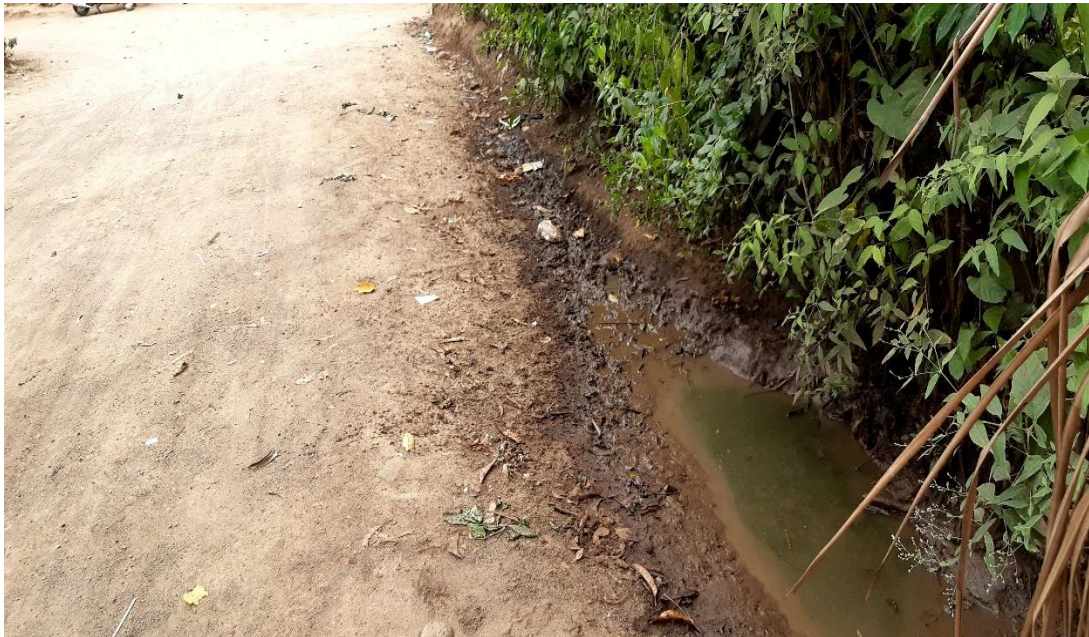
Figura 4: Descarga inadecuada de aguas residuales a las cunetas
