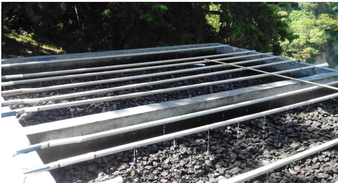
Figura 9: Tratamiento de aguas residuales con filtros percoladores
