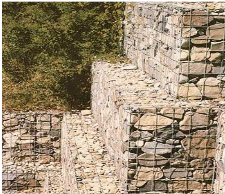
Figura. 15 Gaviones muros de contención
