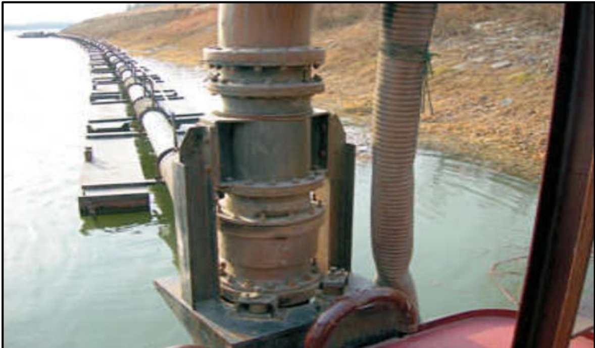
Figura 27. Descarga por tuberías
