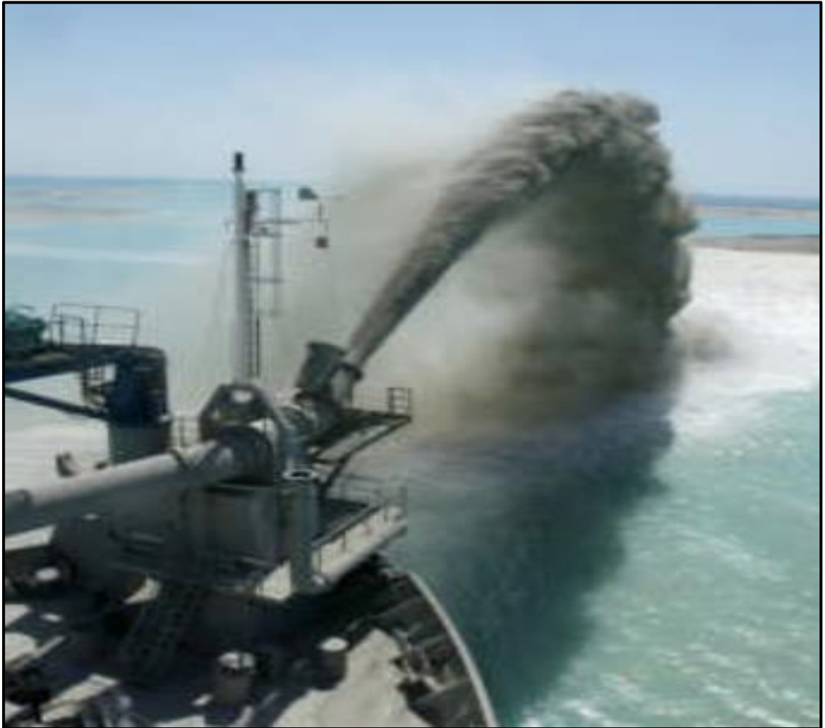
Figura 28. Descarga por bombas
