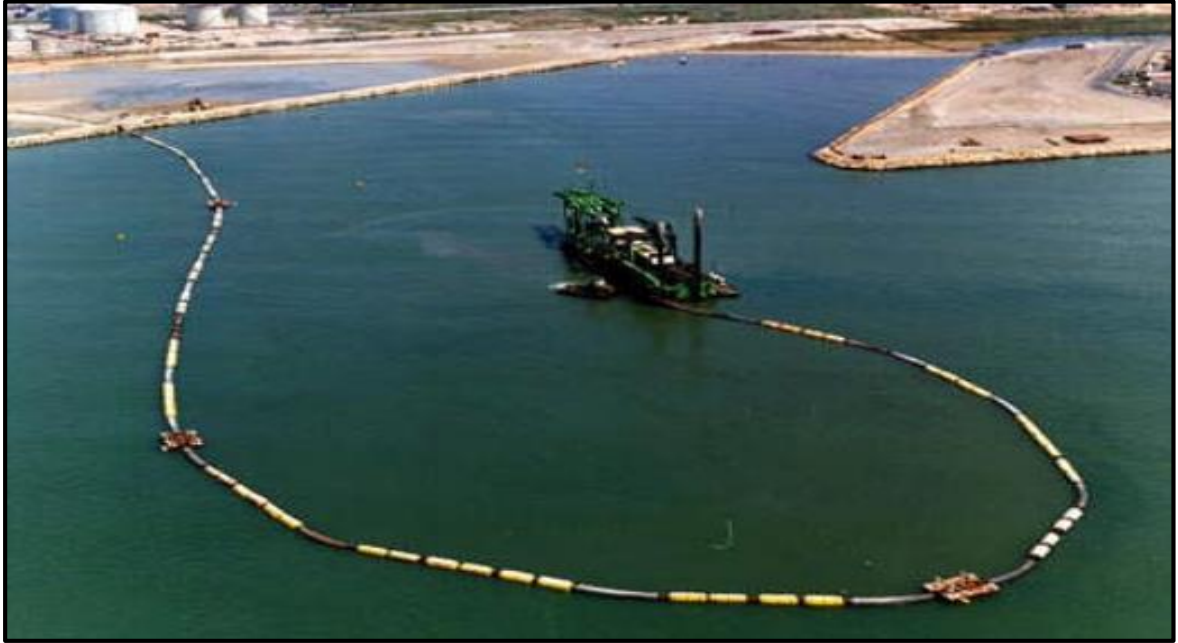
Figura 26. Descarga por tuberías
