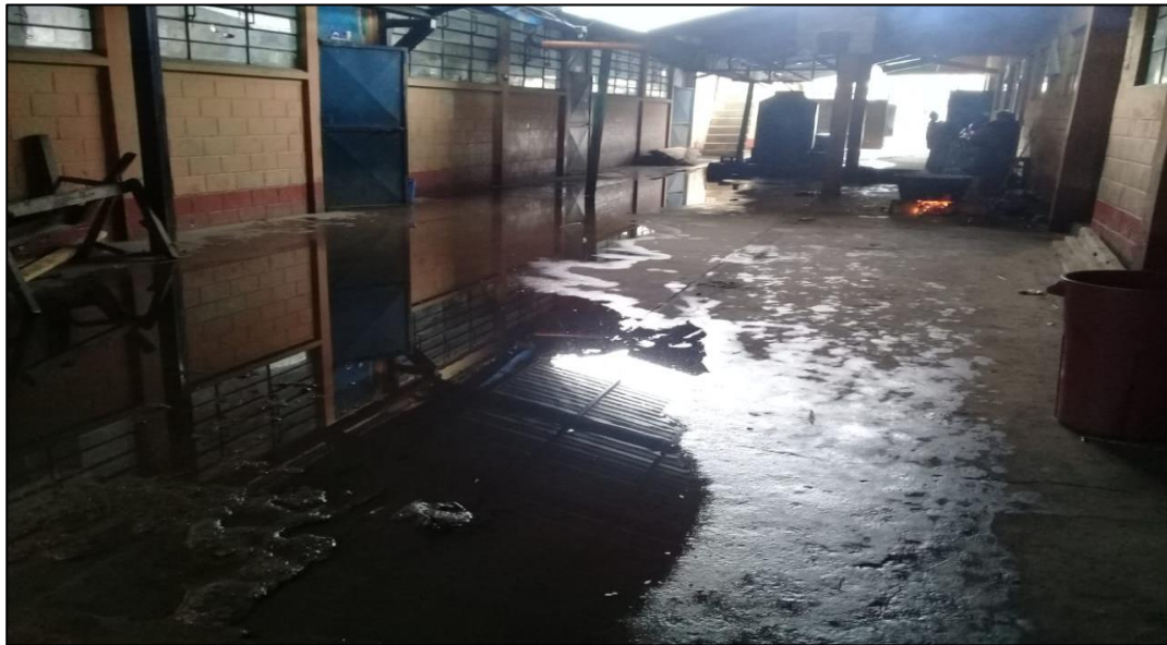
Figura 9. Inundación del centro educativo Paraje Chipastor, San Francisco El Alto, Totonicapán, por deterioro del techo.
