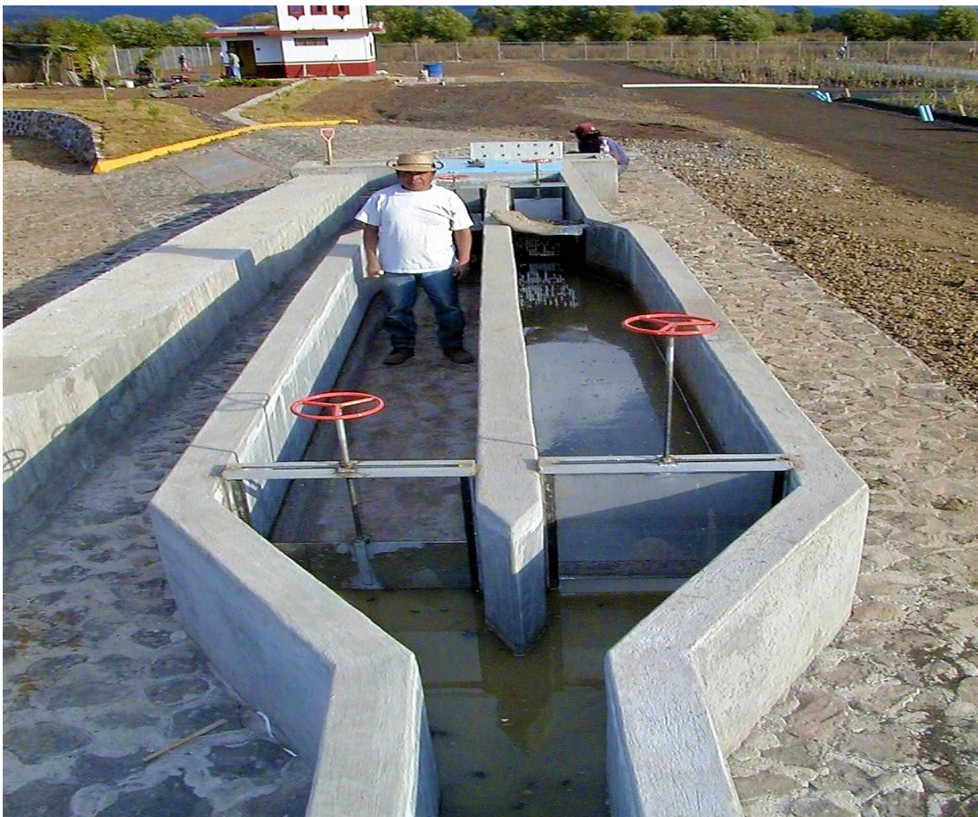
Ilustración 8. Desarenador para planta de tratamiento de aguas residuales.
