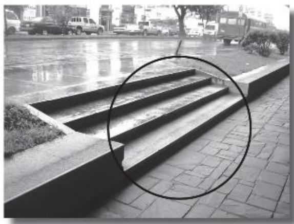
Imagen 7. Barreras para discapacitados, encontradas en la edificación
