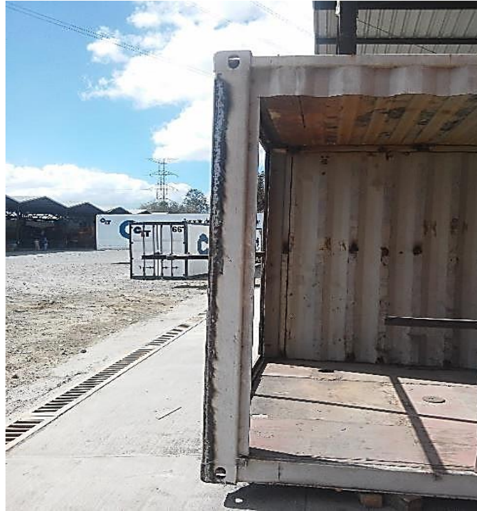
Imagen 5. Poste frontal en contenedor desmantelado
